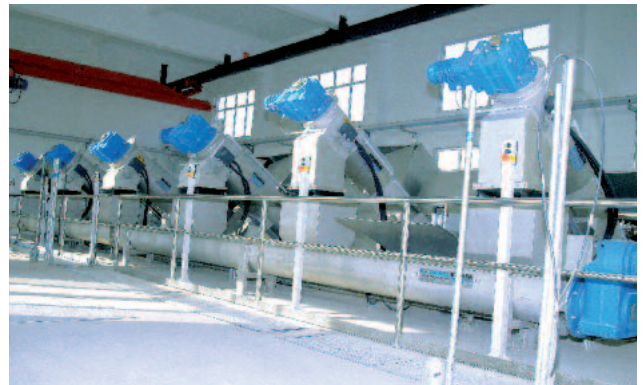
ROTAMAT® RoMem kalvovälppiä asennettu suojaamaan suurta MBR-järjestelmää
