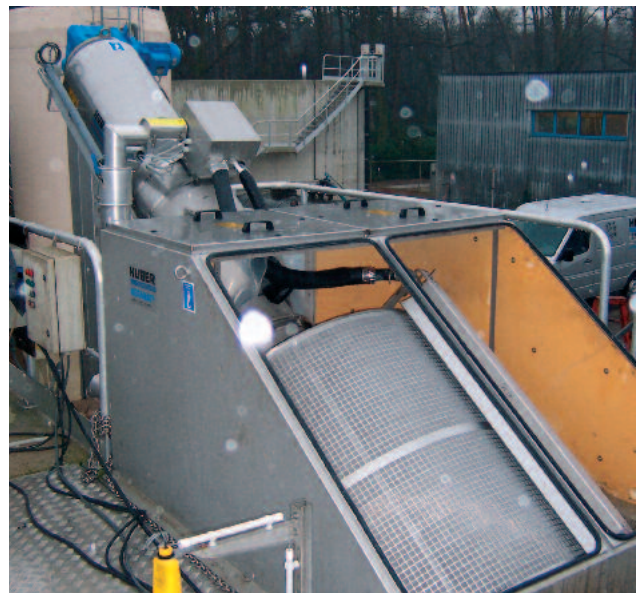
Ulkoasennus. Suojaluukut ja eristetty puhdistusvesilinja.
