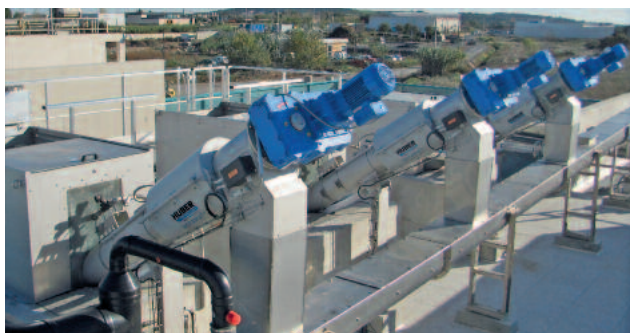
3 установки ROTAMAT® STAR типоразмером 1000 с перфорацией 1.5 мм, предохраняющие последующие мембранные установки
