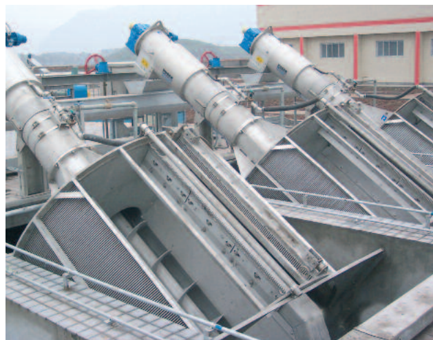
Несколько параллельно установленных в канале барабанных решеток с вращающейся гребенкой HUBER ROTAMAT® Ro1
