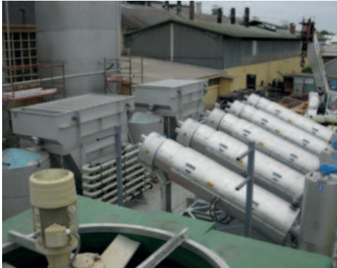
A farostlemez-gyártásnál keletkező iszap víztelenítése és a folyamatvíz kezelése
