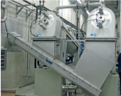
Folyamatiszap víztelenítése az ásványi olaj feldolgozásakor
