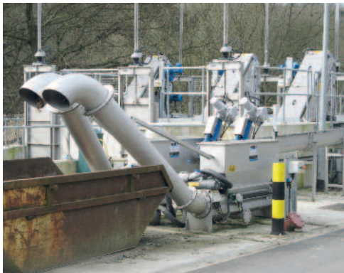
Redundáns üzem és a rácsszemét optimális víztelenítése - a HUBER WAP® L Mosóprés az öblítőtávallyú-adagoláson át
