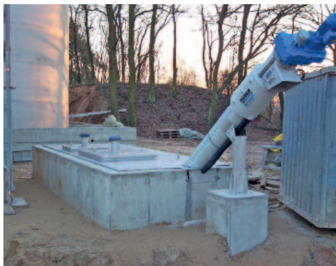
Szűrőberendezés durva anyagok leválasztására a földalatti tartályban
