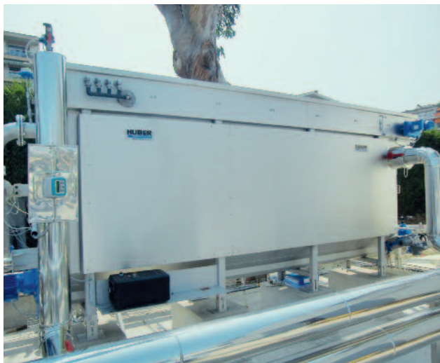
HUBER RoWin lämmönvaihdin asennettu Ranskan rivieralle
