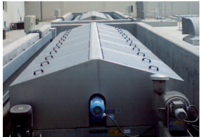
RoDisc® Pyörivä mikrosiivilä, jossa 20 suodatuslevyä on asennettu betonisäiliöön.
