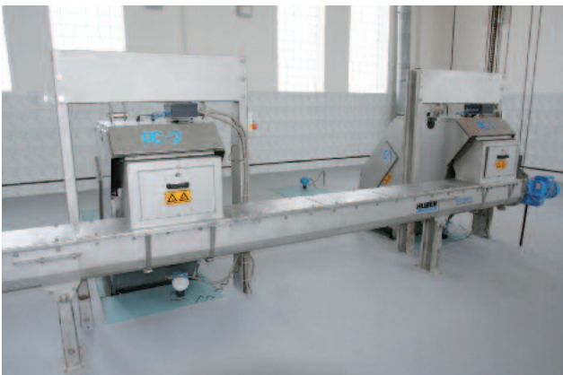
Kaksi vierekkäin asennettua välppää purkaa välppeet yhdelle ruuvikuljettimelle
