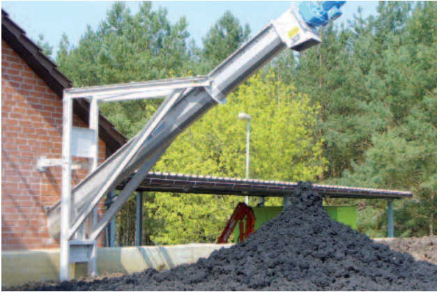
HUBER ROTAMAT® Ruuvikuljetin Ro 8t asennettu lietteenkuivaimen jälkeen.
