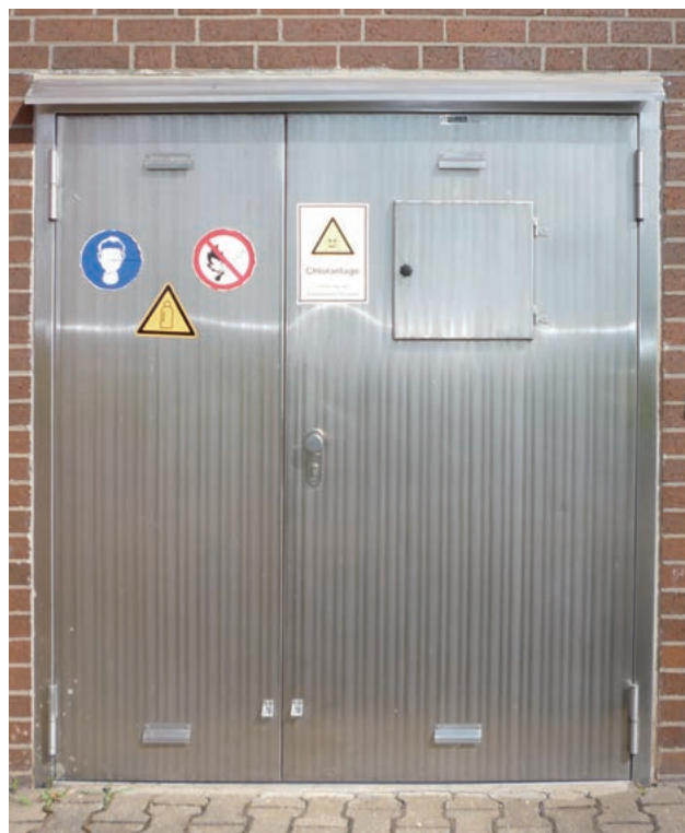
Chlorraumtür Typ TT5.2, mit abgedecktem Sichtfenster
