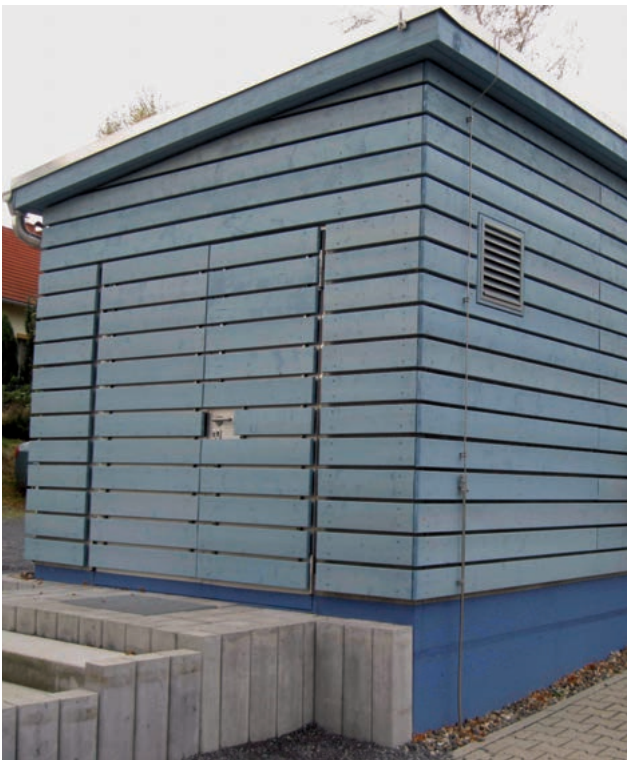
Außentür Typ TT1.2, integriert in die Holzfassade des Bauwerks
