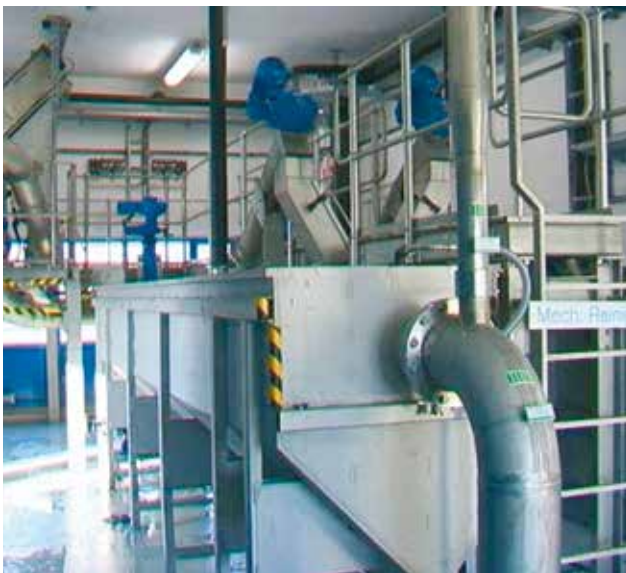
Oberirdische, redundante HUBER Langsandfänge ROTAMAT® Ro6.
