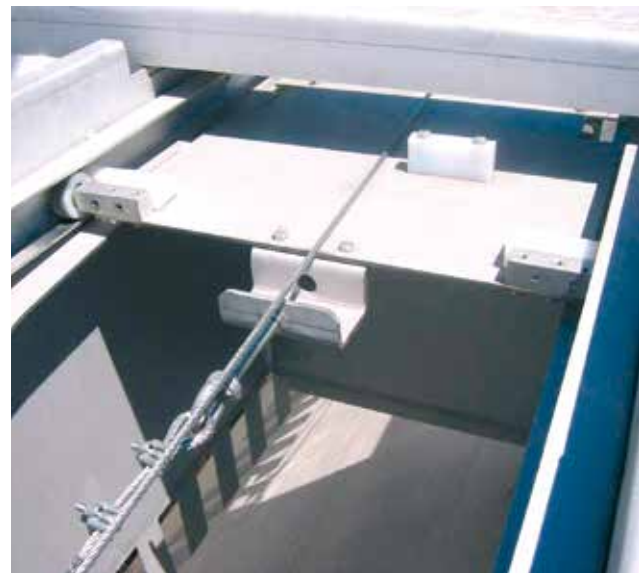
Automatische Fetträumung mittels Fettpaddel.
