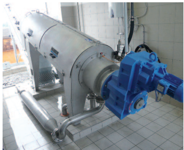
Kiinteästi asennettu kuivain 140 kgTS/h
